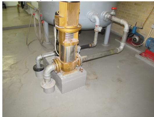
Foto af rentvandspumper
